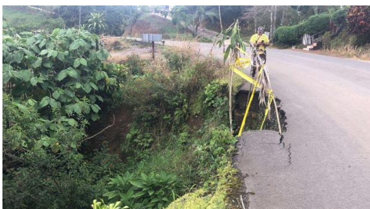
Imagen 1. Deslizamiento de la carretera.
