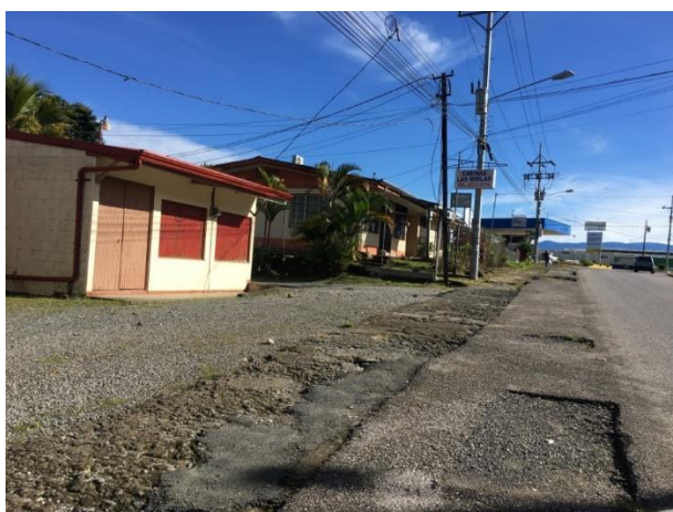
Imagen 10. Aceras en mal estado.
