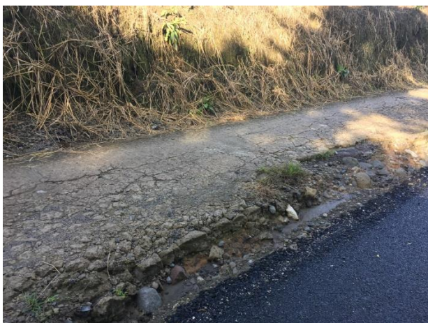
Imagen 8. Aceras en mal estado.
