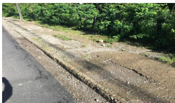
Imagen 9. Aceras en mal estado.
